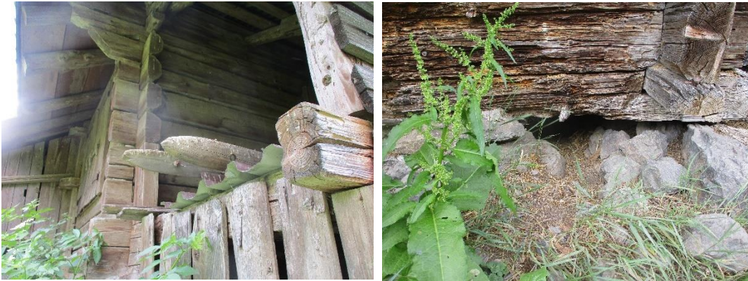
Abbildung 12: Spuren von Vogelbruten und Nutzung durch Kleinsäuger am Holzgebäude
